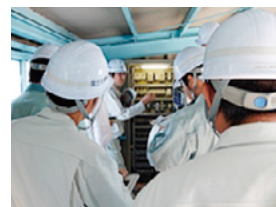
樋門設備の操作、故障対応説明
