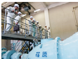
ポンプ設備の点検ポイント説明
