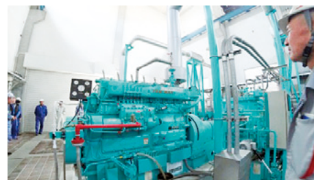
【北溝川排水機場】
