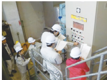
ポンプ設備の操作体験
