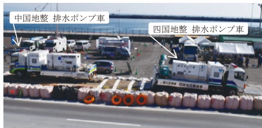
排水ポンプ車設置完了
