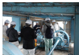
水門設備の操作、故障対応説明
