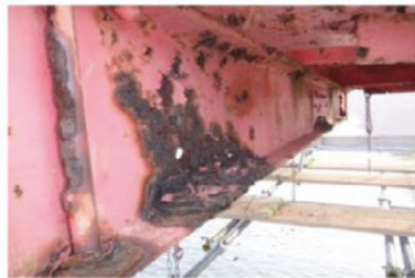
床組の損傷 (鋼部材の激しい腐食)
