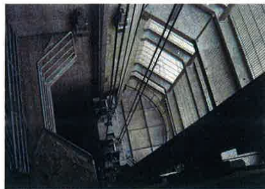
〈青森県 指久保ダム取水設備〉
