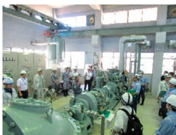
横軸ポンプ（2.5m 3 /s×2台）
