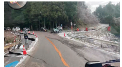
能登町周辺 道路損傷状況
