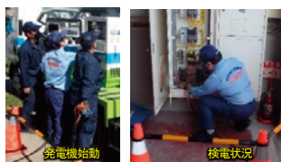
移動用電気工作物（照明車）を活用した電源供給訓練
